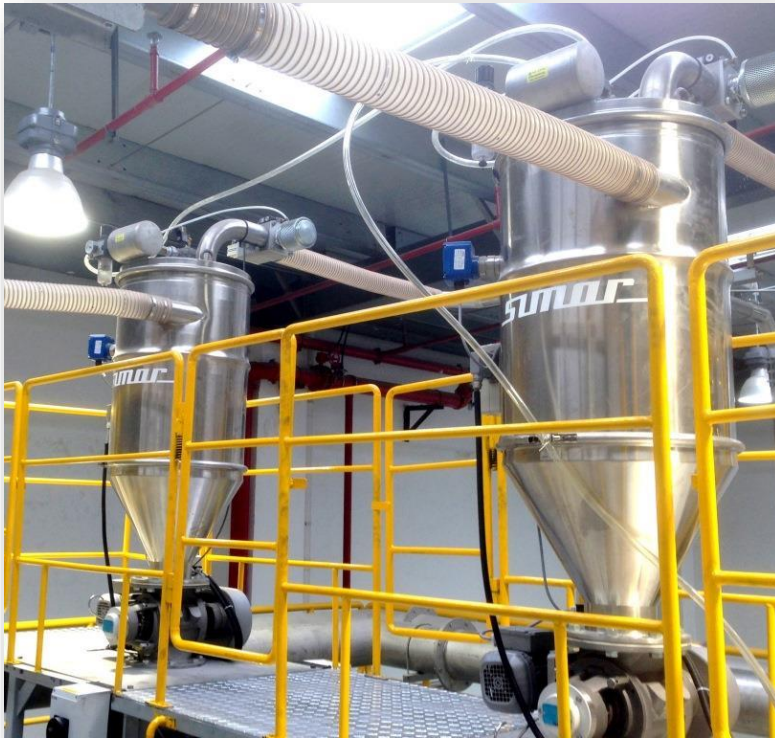
Abscheider einer Zentralanlage mit Zellradschleuse / Separators in a centralised conveying system with rotary valves
